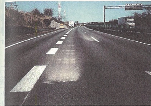
写真-1 高機能舗装の損傷事例（ボンピング）
