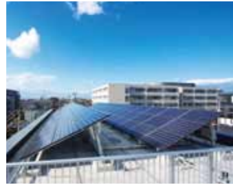
屋上太陽光発電設置事例
