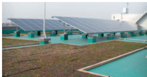
KYB株式会社屋上緑化及び太陽光発電
