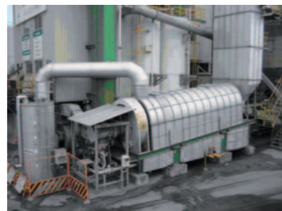
損失熱回収(フード設置)の例(さいたま合材工場)
