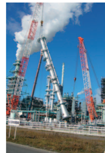
新日本石油精製株式会社 室蘭製油所キュメン製造装置
