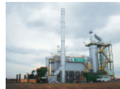
加熱乾燥プラント2号機
